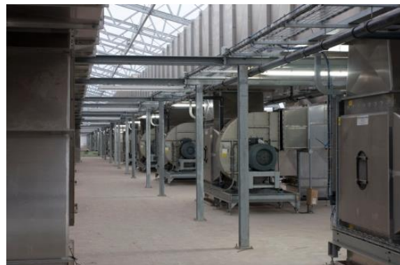
Figuur 6.4: Ventilatorgang tunnelcompostering
