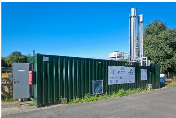
Kleinschalige gasopwaardeerinstallatie van CCS Energie-advies en Greenmac: de Bio-UP.
